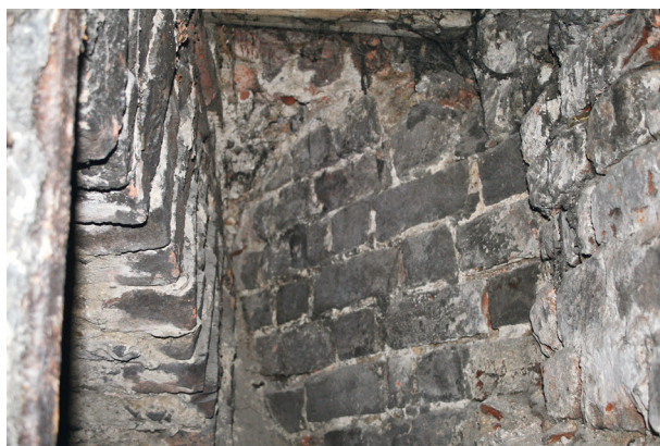
Ryc. 10. Północno-wschodnia część kanału. Fragment przypory gotyckiej kaplicy św. Katarzyny i wpuszczony w nią wtórnie ceglany łuk ściany barokowej furty, fot. M. Goras
