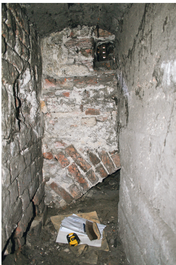
Ryc. 7. Widok kamienno-ceglanej ściany barokowej furty posadowionej na łuku, dostawionej do gotyckiej kaplicy św. Katarzyny. Z prawej strony ściana kanału osuszającego, fot. M. Goras
