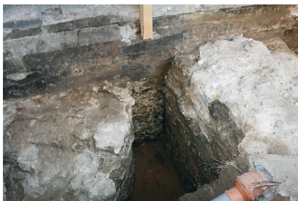
Ryc. 3. Wykop przed elewacją zachodnią. W wykopie fragment kolistej wieży i z prawej strony korona muru barokowej kaplicy św. Antonina, fot. W. Niewalda
