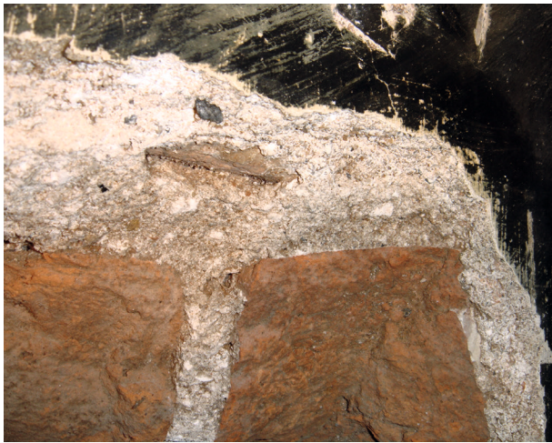
Fragment ściany wschodniej. Widoczny watek ceglany z oryginalną zaprawą, 2007, fot. W. Stefańska
