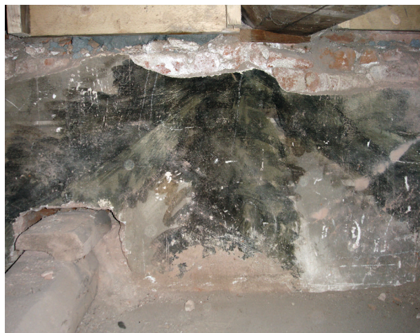
Fryz pod podłogą na drugim piętrze, ściana zachodnia, stan przed konserwacją, 2007, fot. W. Stefańska
