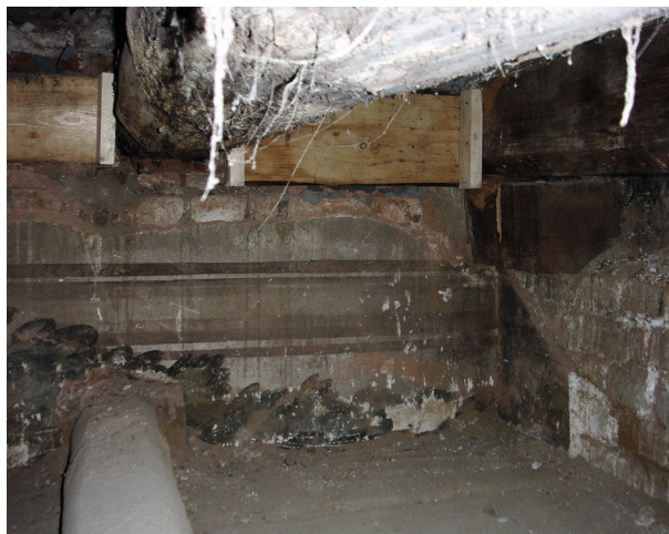
Fryz pod podłogą na drugim piętrze, narożnik północno-zachodni, stan przed konserwacją, fot. W. Stefańska
