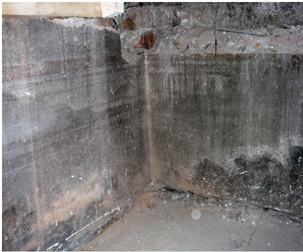
Fryz pod podłogą na drugim piętrze, narożnik południowo-wschodni, stan przed konserwacją, 2007, fot. W. Stefańska
