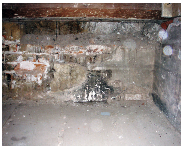
Fryz pod podłogą na drugim piętrze, narożnik południowo-zachodni, stan przed konserwacją, fot. W. Stefańska
