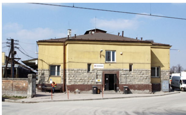
Zniekształcony „modernizacją” elewacji dawny budynek urzędu nadawczego Kolei Państwowej (rejon bramy IV); fot. D. Lulewicz, 29 marca 2011 r.
