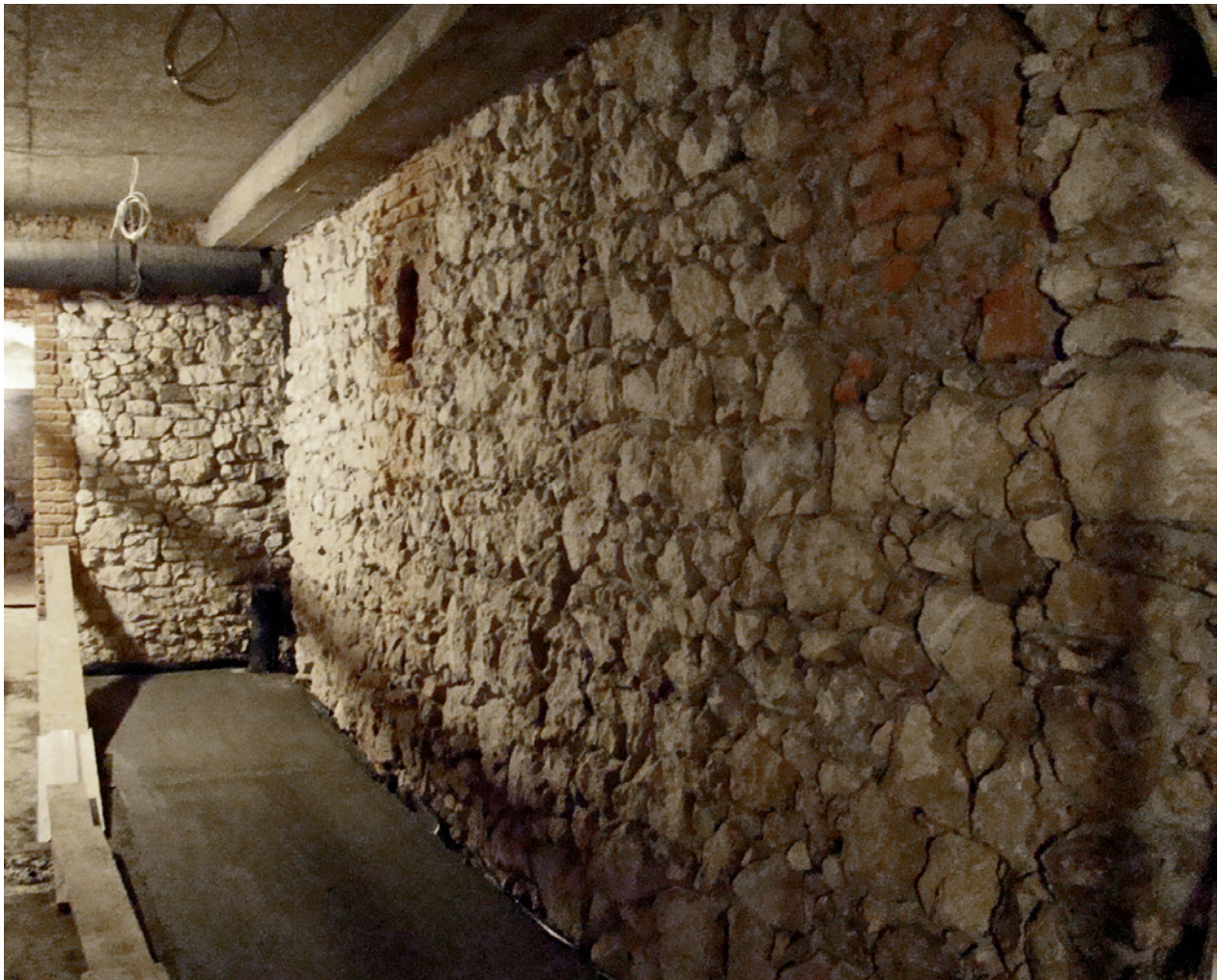
Ryc. 22. Północna część hali Sukiennic, korytarz. Fundament muru zamykającego Sukiennice od północy oraz zachodniego skrzydła Sukiennic (w głębi). W murze północnym widoczne ceglane łaty w miejscu uszkodzeń spowodowanych budową kanału blokowego w XIX w. (z prawej) oraz z budową korytarza pod północną częścią hali i wykonaniem otworu drzwiowego do podziemi pod zachodnim skrzydłem Sukiennic. Widok od wschodu; fot. E. Zaitz
