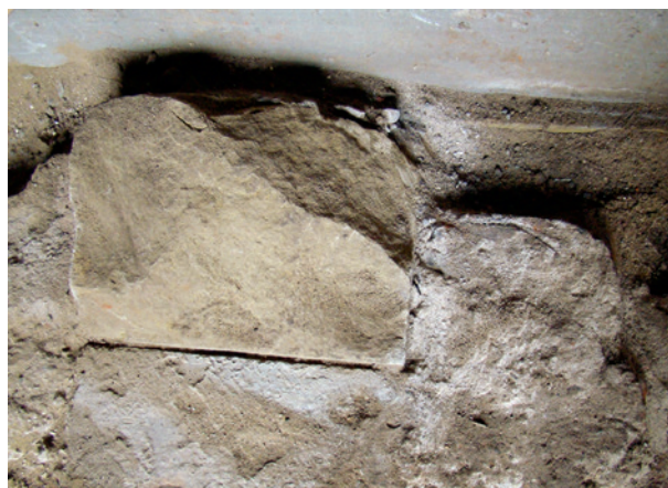
Ryc. 14. Północna część hali Sukiennic, wykop 34. Resztki piaskowcowego węgara domniemanego portalu arkady bramnej oraz detalu wapiennego o zaokrąglonym narożniku, osadzonych na koronie fundamentu renesansowego muru poprzecznego. Widok od północy; fot. E. Zaitz
