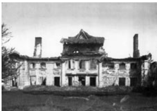
Pałac w Czarkowach po spaleniu przez Rosjan ok. 1918 r., wł. Wojewódzkiego Urzędu Ochrony Zabytków w Kielcach
