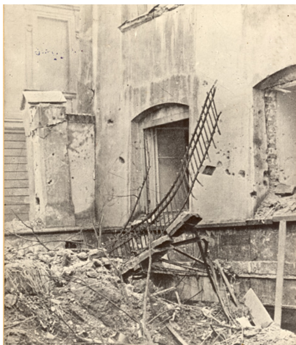
Zniszczenia budynku Collegium Minus przy ul. Gołębiej 11. Widok od strony ogrodów profesorskich, na pierwszym planie rumowisko gruzu, kamieni, gałęzi, zerwanych barierok. Po prawej stronie widoczny fragment północnej fasady budynku i fragment murewanego ogrodzenia ogrodów. W głębi fragment fasady budynku stojącego przy ul. Jagiellońskiej, 18 stycznia 1945 r.; w zbiorach MK, nr inw. MHK-Fs20617/IX
