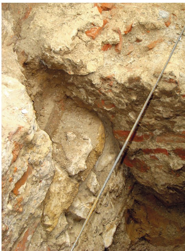
Ryc. 33. Ogród przy północnej ścianie kościoła. Lico fundamentu i północnej ściany świątyni odkryte między murami barokowej elewacji. Widok z góry, od północy; fot. Emil Zaitz
