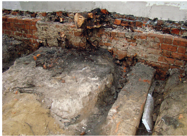
Ryc. 17. Środkowa część dziedzińca. Zachodnia ściana lazaretu częściowo uszkodzona przez korzenie drzewa. W rejonie wtórnie zamurowanego otworu drzwiowego ślady tynku, wewnątrz budowli fundament barokowej ściany działowej (z prawej) oraz wylewka zaprawy wapiennej z odciskami posadzki wykonanej z cegieł palcówek i płytek (?). Widok od wschodu, z wnętrza lazaretu; fot. Emil Zaitz
