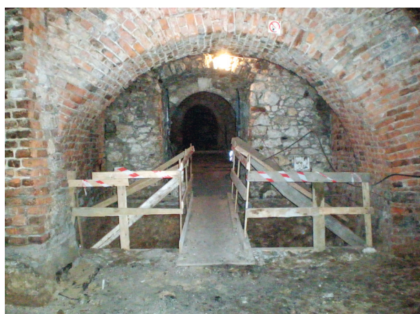
Widok od zachodu na pomieszczenie piwniczne z odkrytym cembrowanym zbiornikiem (lodownią), fot. J. Pierzak, 2012
