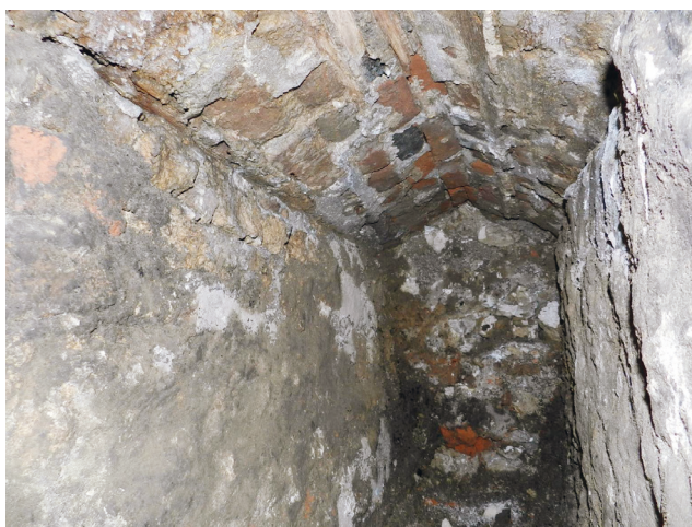
Wykop po przejeździe na dziedziniec. W kamiennym murze zamkniętym najstarszy dom od strony południowej wąski kanał. W głębi w odległości 145 cm od południowego lica muru kamienno-ceglana zamurówka, fot. E. Holcer
