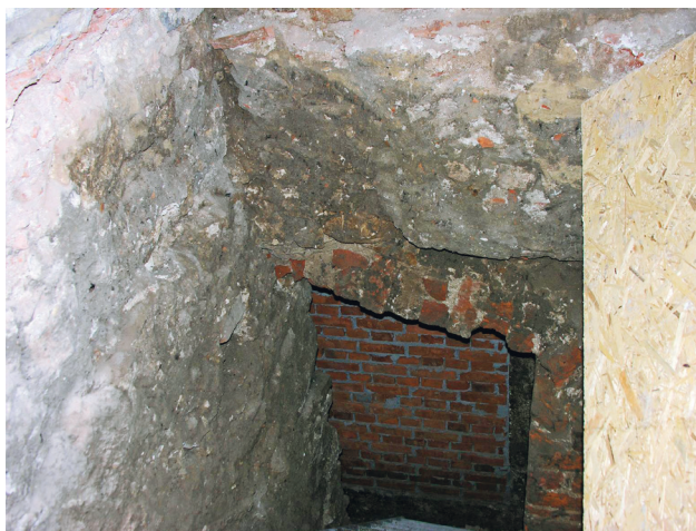
Parter, klatka schodowa, narożnik północno-zachodni. W wykopie pod podłogą otwór dawnego wejścia z portalem. W ceglonym łuku głębokie wykucie. Nad nim ściana północna, przemurowana i związana w narożniku z kamienną ścianą zachodnią, fot. Ł. Holcer
