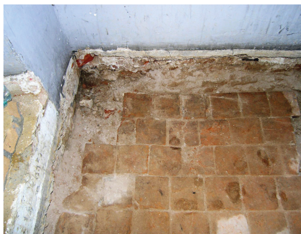
Parter, klatka schodowa, narożnik północno-zachodni. Pod poziomem ostatniej podłogi częściowo zachowana posadzka ceramiczna, fot. Ł. Holcer
