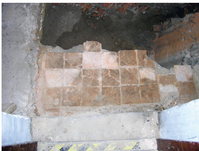
Parter, klatka schodowa, część wschodnia. Pod poziomem ostatniej podłogi częściowo zachowana posadzka ceramiczna, fot. Ł. Holcer
