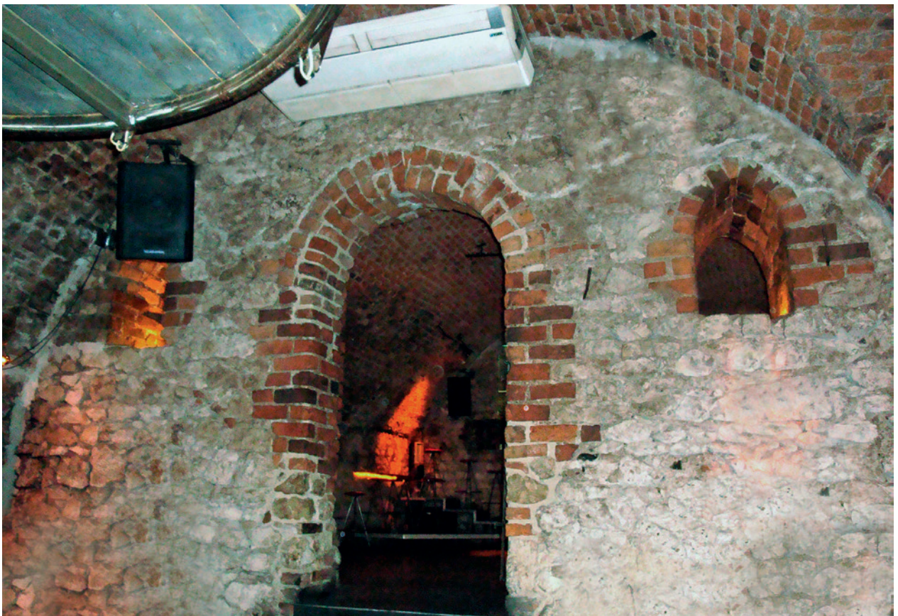
Ulica Bracka 3/5, piwnice – elewacja wschodnia pierwszej kondygnacji domu wieżowego wójta Henryka, koniec XIII w.; fot. M. Łukacz
