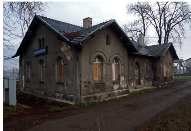
Budynek dworca na stacji Kraków-Bieżanów wybudowany w 1859 r. Najstarszy zachowany w oryginalnym kształcie budynek kolejowy w Krakowie. Aktualnie obiekt nieużytkowany i zaniedbany, fot. D. Lulewicz, 2008
