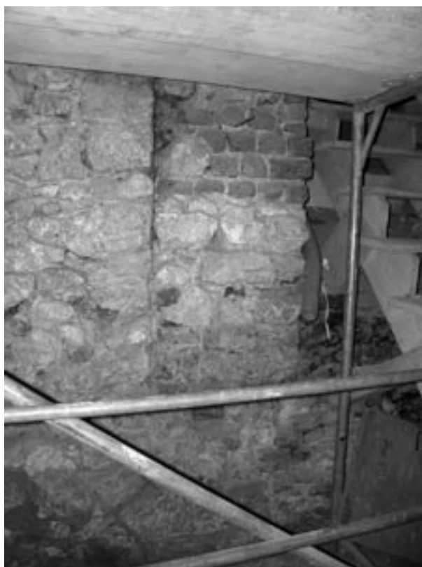
Ryc. 15. Fragment północnej ściany w pomieszczeniu z fazy IV. Lewe ościeże obszernego otworu wyjścia na ulicę Szczepańską, fot. Ł. Holcer
