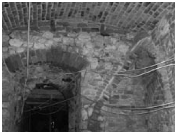
Ryc. 11. Zachodnia ściana w pomieszczeniu z fazy IV. Odcinkowe nadproże nad wejściem i fragment ceglany wążku usytuowanego na dawnej odsadzce. W narożniku pozostałości późniejszej kapy piecowej, fot. L. Holcer
