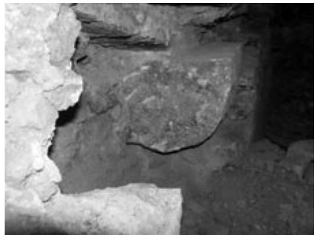
Ryc. 18 Kamienna konsola odsłonięta pod posadzką sieni. Pod przęsłem ściana niższej kondygnacji cofnięta, lico zniszczone, fot. Ł. Holcer
