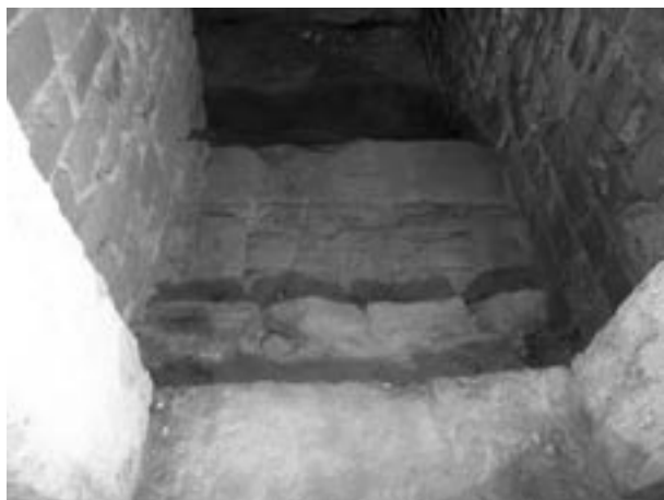
Ryc. 31. Ceglana posadzka i kamienne stopnie we wtórnie wykutym przejściu do XIII-wiecznego domu, fot. L. Holcer
