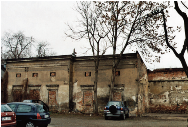
Ryc. 6. Kraków – Piasek, klasztor oo. Karmelitów, budynek dawnej stolarni oraz mur graniczny między nią a oficyną, od zachodu, fot. E. Zaitz
